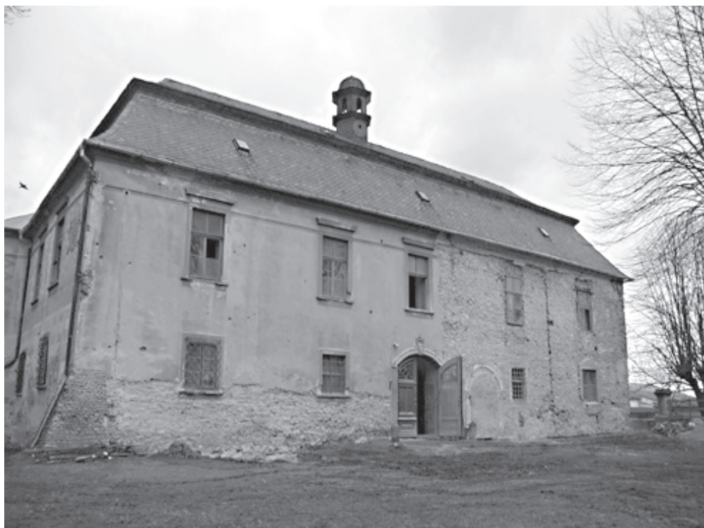
Obr. 2. Štáblovice, zámek. Východní průčelí. Spára prozrazující mladší renesanční přístavbu a zazděný portál
